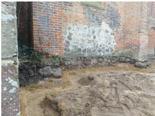
Abb. 2: Lehm packungen an der Südseite der Kirche.
