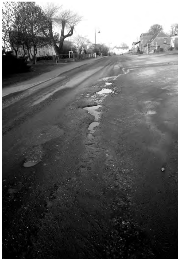
Die Schlaglochpiste in Krempin ist eine Hinterlassenschaft des Winters.
